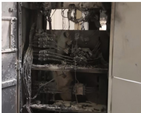
图 1 无功补偿柜起火照片
