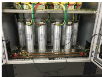
图 2 电容器柜内接地放电操作
